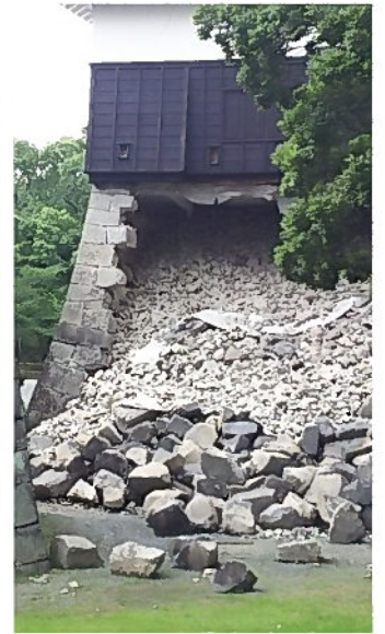
崩れた熊本城の 城壁 (写真上)
